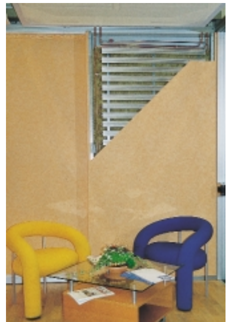
Die bauteilintegrierte Flächenkühlung für Wohn- und Schlafräume oder Büros wurde transparent gemacht
