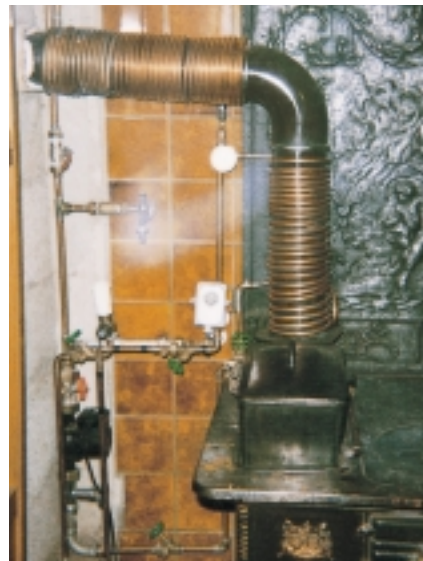
Kunde mit Erfindergeist baute die etwas andere Zentralheizung
