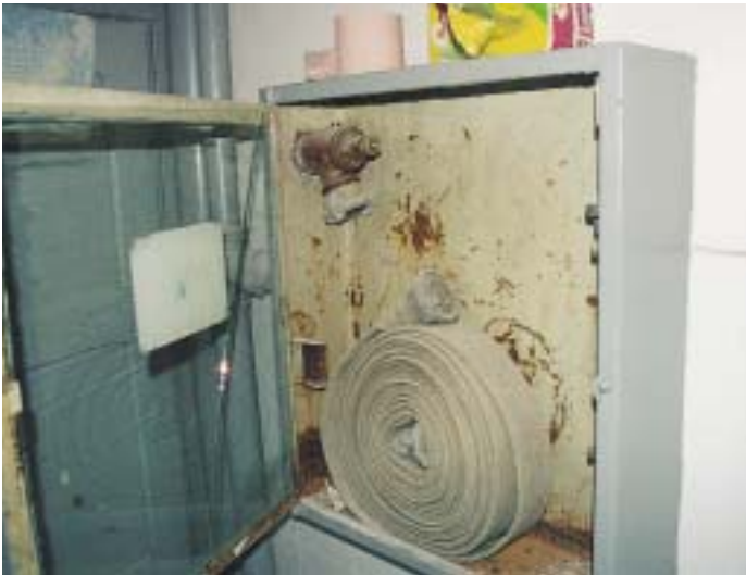
... und die Installateure staunten nicht schlecht: Ein Wandhydrant ohne Handrad, Brandschutz vom Feinsten
