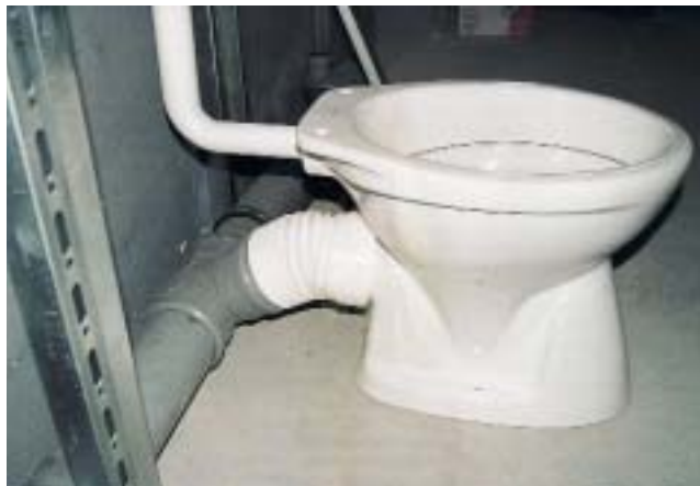
Nicht mit der DIN 1986 in Einklang zu bringen. war die rumänische Art des WC-Anschlusses mit einem 87°-Abzweig
