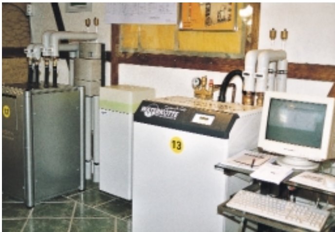
Bestandteil des geschlossenen Energieversorgungssystems sind Wärmepumpen unterschiedlichen Typs
