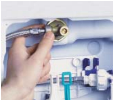
Kein Werkzeug mehr nötig: Ohne Zange und Schlüssel ist der Anschluß des Panzerschlauchs am Eckventil dicht
