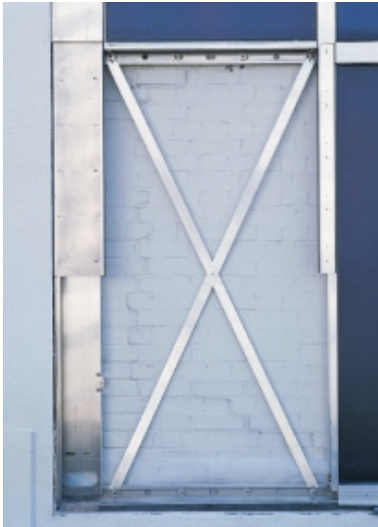
Solarfassade eingebunden in ein Wärmedämmverbundsystem
