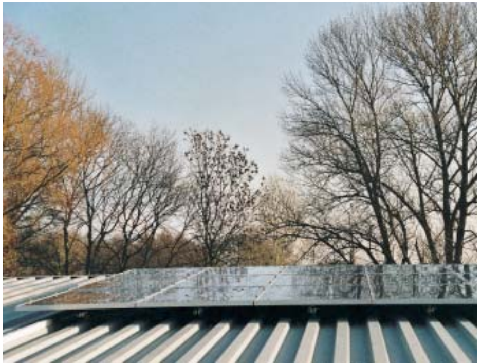
Die Hinterlüftung der PV-Module wirkt sich positiv auf Leistungsfähigkeit der Platten aus
