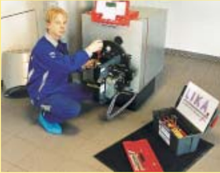
In der Praxis arbeiten die LIKA-Lehrlinge, wie hier bei der Brennerwartung, vollkommen selbständig
