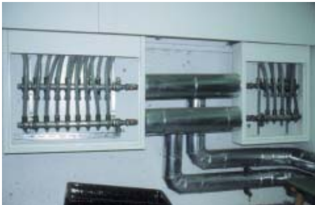
Im gesamten Neubau wurden vier Heizkreisverteiler mit 25 Heizkreisen eingerichtet
