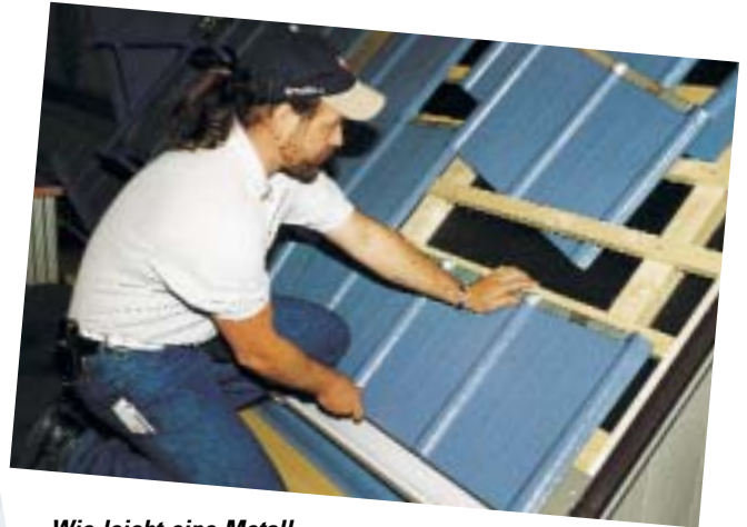
Wie leicht eine Metallbedachung mit kleinformatischen Aluminium-Deckelementen von statten geht, wurde am Prefa-Stand eindrucksvoll demonstriert
