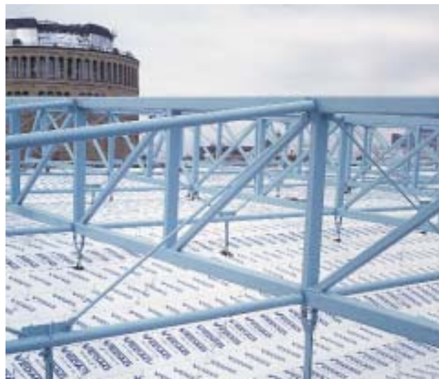
Abgehängtes Dach mit bereits verlegter Dampfsperre und in gleichmäßigem Abstand angeordneten Befestigungs-Klipps für die Kalzip-Bahnen
