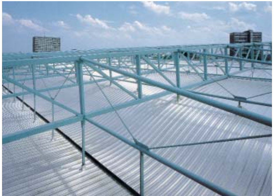
Dort, wo das Tragwerk des Daches die Kalzip-Dachhaut durchdringt, wurden Aufsatzkränze eingeschweißt, um die Dichtigkeit sicherzustellen
