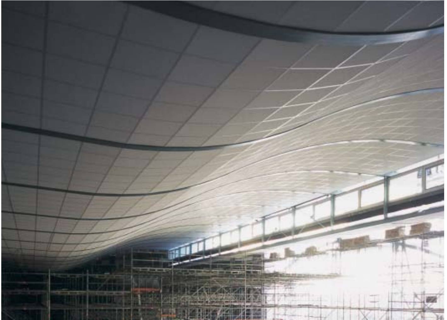
Die geschwungene, mit schallabsorbierenden Rockfon-Kassetten versehene Deckenkonstruktion symbolisiert das Wellenspiel des Wassers
