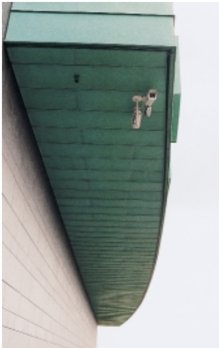
Die Unteransicht des überkragenden Gebäudeteiles zeigt den mit Lochblech abgedeckten Schlitz für die Hinterlüftung
