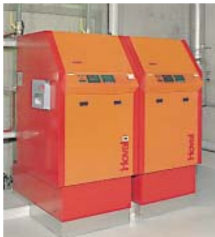
Doppelkessel Hoval UltraGas mit einer Nennleistung von 700 kW
