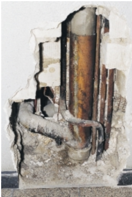
Hier hat jemand mit Kupferblech versucht, an einer Schmutzwasserfalleitung aus PP-Rohr einen nachträglichen Anschluß herzustellen
