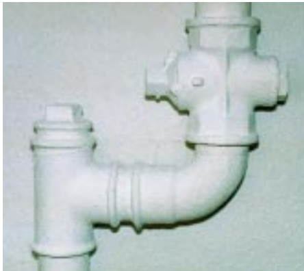
Eine Druckprobe läßt vom Keller aus nicht erkennen, ob die Leitungsöffnungen – wie hier – fachgerecht mit metallenen Stopfen verwahrt sind
