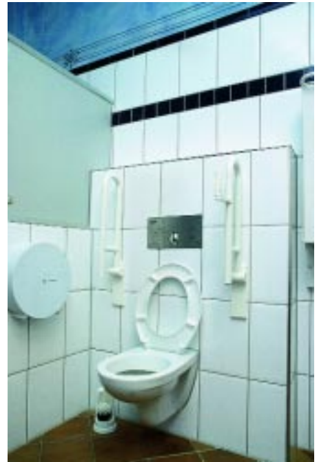
Vandalensichere Betätigungsplatten der Spülung und herunterklappbare Haltegriffe im neuen, behindertengerecht eingerichteten WC [2]
