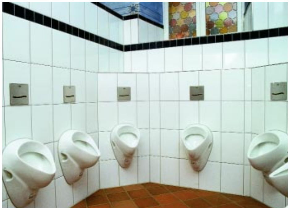
Ausgestattet mit Einzelurinalen und infrarotgesteuerter Spülung vermitteln die Anlagen Hygienegefühl; außerdem wird noch Wasser gespart [2]
