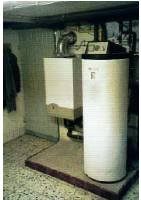
Anlage 6 Einfamilienhaus, Heizgerät mit Speicher, Schornstein mit Nebenlufterrichtung (Zugbegrenzer) trocken
