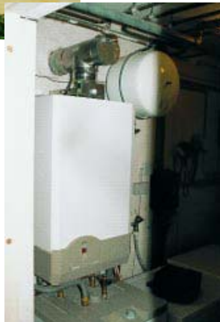
Anlage 5 Einfamilienhaus, Heizgerät mit Speicher, Schornstein mit Nebenlufterrichtung (Zugbegrenzer) trocken
