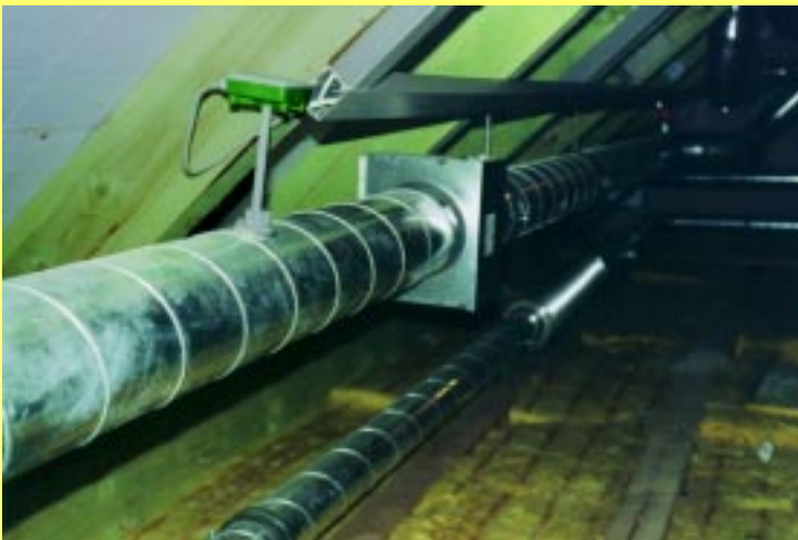
Die Warmluftverteilung erfolgt über im Spitzboden installierte Wickelfalzrohre
