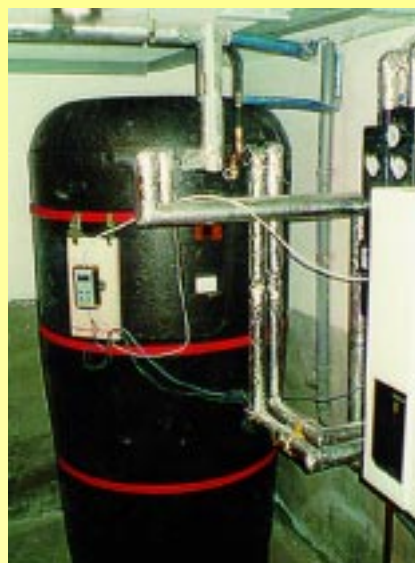
Der Warmwasser- speicher mit 500 l Inhalt wird im Win- ter über die Hei- zungsanlage und im Sommer über das Solar-Luft-Sy- stem auf 70 °C er- wärmt
