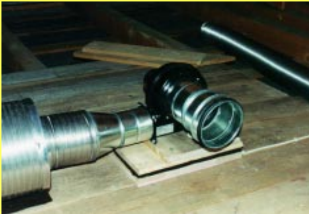
Die Gleichstrom-Ventilatoren werden mit der in den PV-Modulen erzeugten elektrischen Energie betrieben
