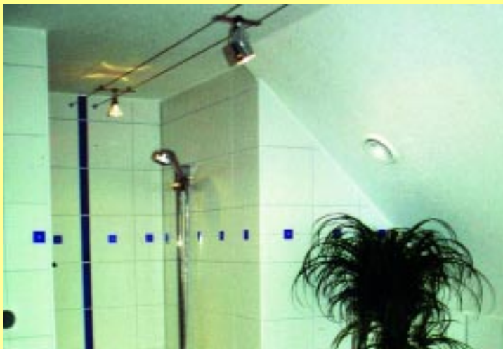
Einer der Luftauslässe des Solar-Luft-Systems ist beispielsweise im Badezimmer angeordnet
