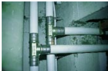
Die Wohnungsanschlüsse wurden durch 300 x 500 mm große Öffnungen in der Schornsteinwange realisiert
