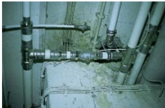
Die Leitungsabgänge in die einzelnen Wohnungen lassen sich bei Bedarf durch Kugelhähne absperren
