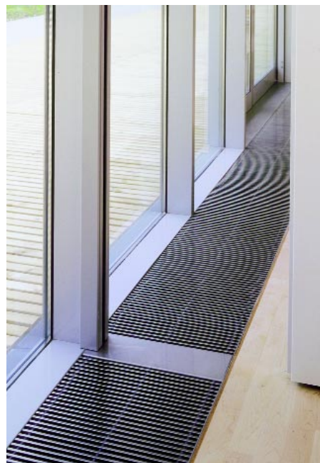
Bild 12 Unterflurschacht mit Roll-Rost Edelstahl im Verwaltungsgebäude HUK Coburg
