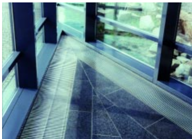
Bild 14 Gehrungsecke eines Unterflurschachtes im Verwaltungsgebäude Deutsche Bank AG, Berlin
