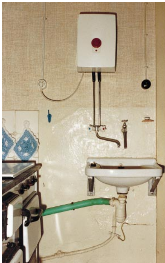
In vielen Haushalten Mittel-, Nord- und Ostdeutschlands steht der Austausch bestehender Bleirohrleitungen noch bevor
