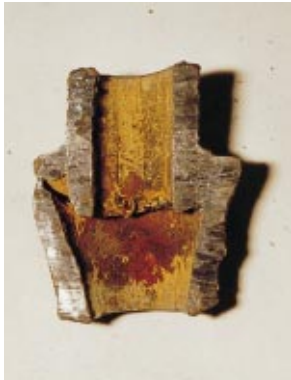
Auch in Bleirohren bildet sich im Laufe der Zeit eine Schutzschicht
