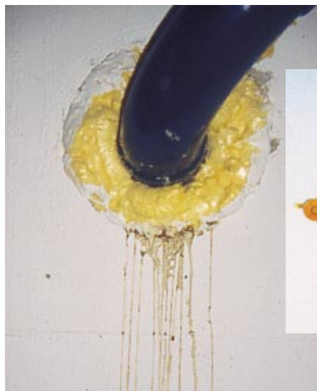
Durch Ausschäumen können Rohrdurchführungen kaum gegen eindringendes Wasser abgedichtet werden
