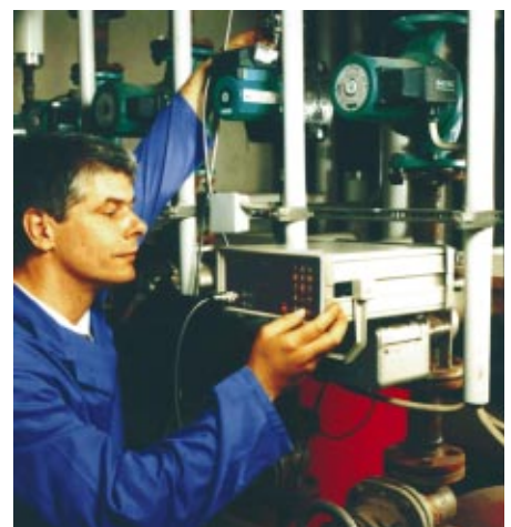
Eine der Leistungen des Wittener Unternehmens ist die Energieanalyse, die keine Franchisepartnerschaft voraussetzt
