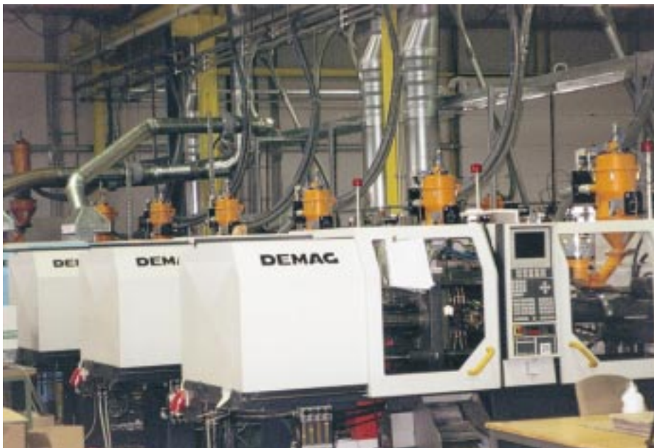
Druckluft wird in vielen Werkstätten benötigt, so auch bei den Spritzgußmaschinen eines Rochlitzer Kunststoffteile-Unternehmens
