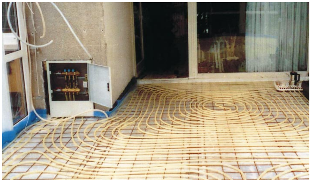
Zur möglichst effektiven Nutzung der Wärme wurde eine sehr eng verlegte WW-Fußbodenheizung geplant, die mit extrem niedriger Vorlauftemperatur gefahren werden kann
