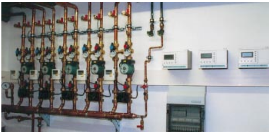
Aufgeräumt: Regelstrecken, Steuerung und Unterverteilung als zentrale Komponenten für die gleichmäßige und sparsame Energienutzung
