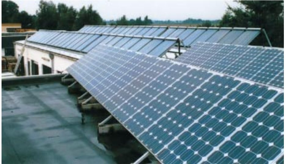
Rund 60 m 2 Solarkollektoren haben die Anlage am Niederrhein zur größten dieser Art in Nordrhein-Westfalen gemacht
