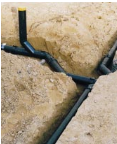
Undichte Grundleitungen fallen niemandem auf. Deshalb ist die Abnahmeprüfung und die wiederkehrende Kontrolle besonders wichtig
