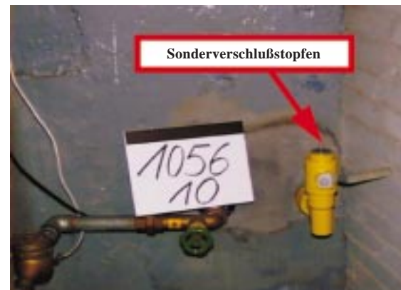
Anschlußleitungen ohne Entnahme werden seit Ende 1997 mit Sonderverschlußstopfen gesichert
