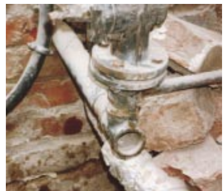
Bei der Gasinstallationsanlage in der Krahestraße 8, Düsseldorf, fehlte der 1 1/2 zöllige Verschlusstopfen
