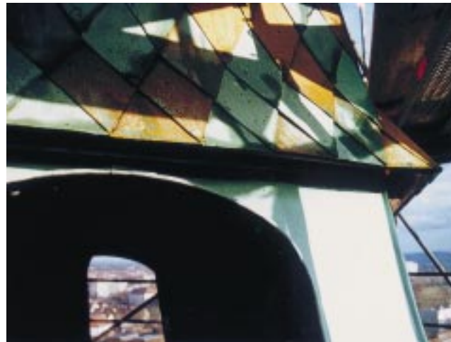
Dank der bei der Abnahme der Schindeln vorgenommenen Nummerierung schritt die Neubekleidung zügig voran ...
