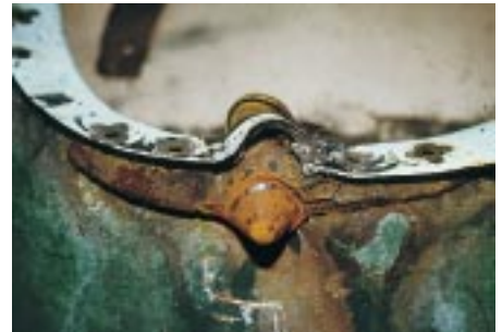
... die besonders die aus normalem Baustahl hergestellten Lager in Mitleidenschaft gezogen haben
