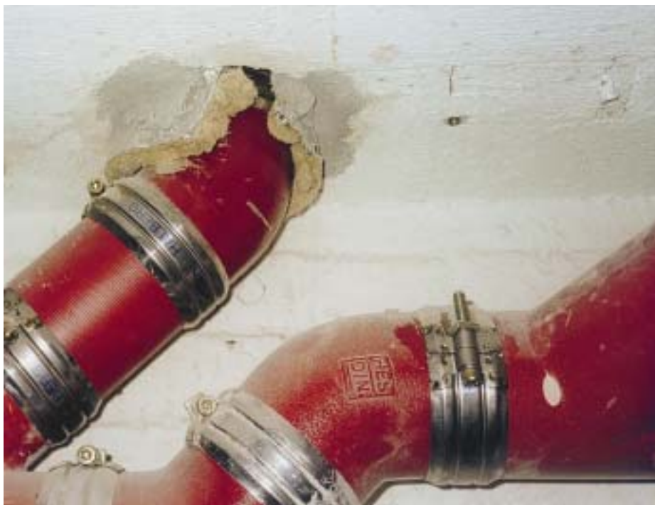
Diese Rohrdurchführung ist wohl kaum rauchdicht
