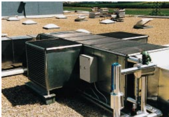
Über kurze Stichkanäle versorgt die Dachlüftungszentrale von Menerga die Halle mit aufbereiteter Frischluft
