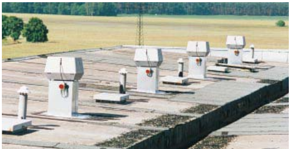
Typisches Einsatzbeispiel der Rauchsauger (mit roten Sicherheitsabschaltern) im Rahmen einer Heizungsanierung bei einem Wohnblock in Plattenbauweise
