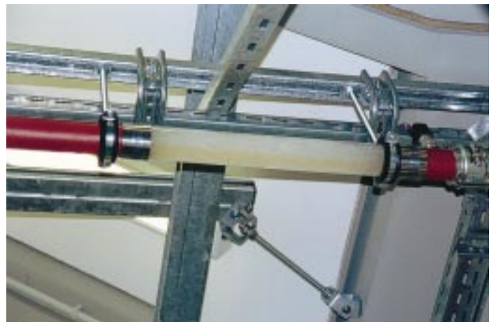
Die Glasrohre zeigen deutlich, wann eine Vollfüllung der Leitungen erreicht und wann ungewollt Luft mitgerissen wird
