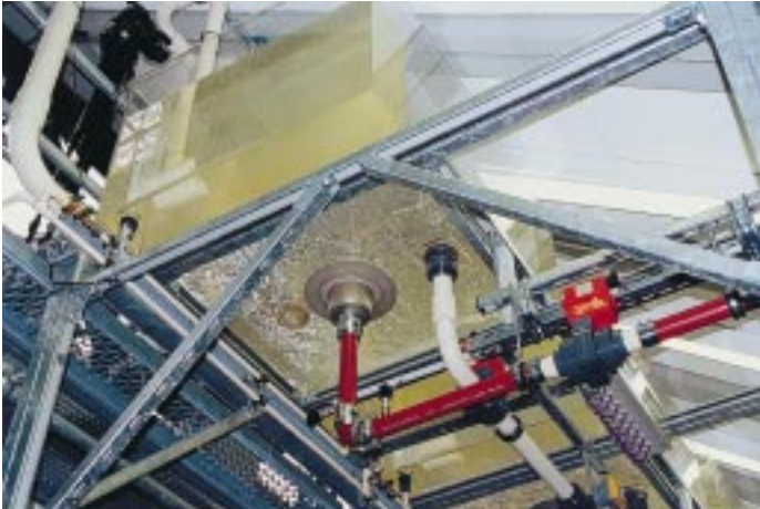
Ein Dachablauf in der Versuchsanlage: Verschiedene Ablaufsituationen können simuliert werden
