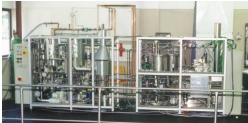
Die PEM-Brennstoffzellen-Hausenergie-Versorgungsanlage mit Erdgasreformer an der FH Ulm bringt im Vollbetrieb ca. 5 kW elektrische Leistung
