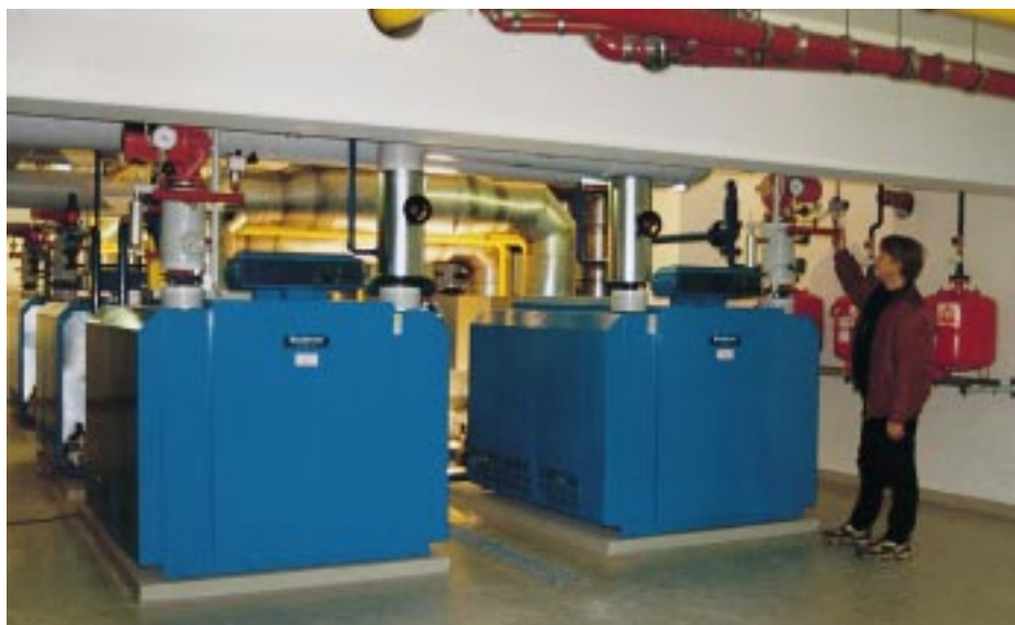
Sechs NT-Heizkessel mit einer Gesamtwärmeleistung von 1800 kW wurden im UG der neuen Reha-Klinik installiert
