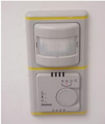
Thermostat und Präsenzmelder sind über den EIB für die bedarfsgerechte Heizungsregelung miteinander verknüpft
