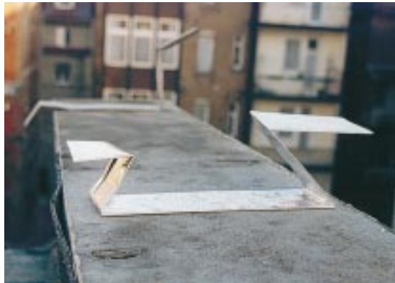
Die Halterungen der Mauerabdeckung aus Edelstahlblech wurden durch die Windkräfte skurril verformt
