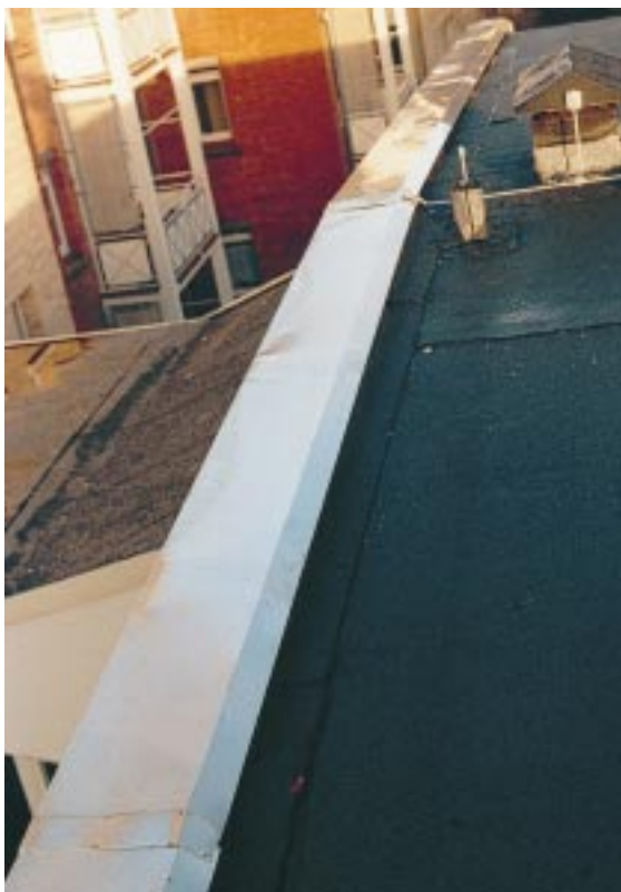
Die Mauerabdeckung am gegenüberliegenden Gebäudeende ist intakt geblieben; an ihr läßt sich die Verarbeitung und die Einbindung in die Blitzschutzanlage erkennen
