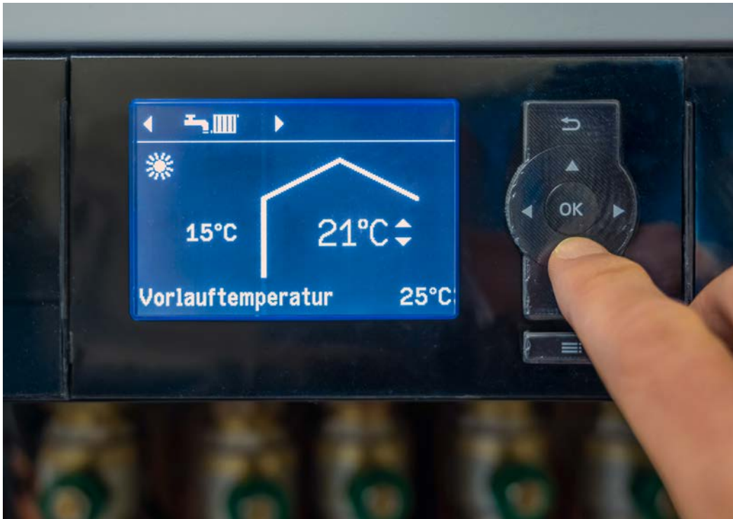
Ein Teil der Heizungsoptimierung umfasst die richtige Einstellung der Regelung.
